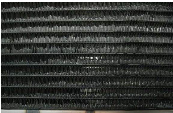
Bild 19: Anlagerung von Wasser beim Abtauvorgang zwischen den Lamellen des Umgebungswärmetauschers (Verdampfer)
